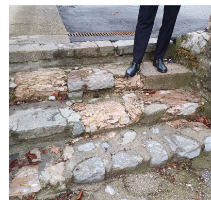
Primer »škrbinastih« stopnic s Kidričeve ceste do Lahovega mostu
